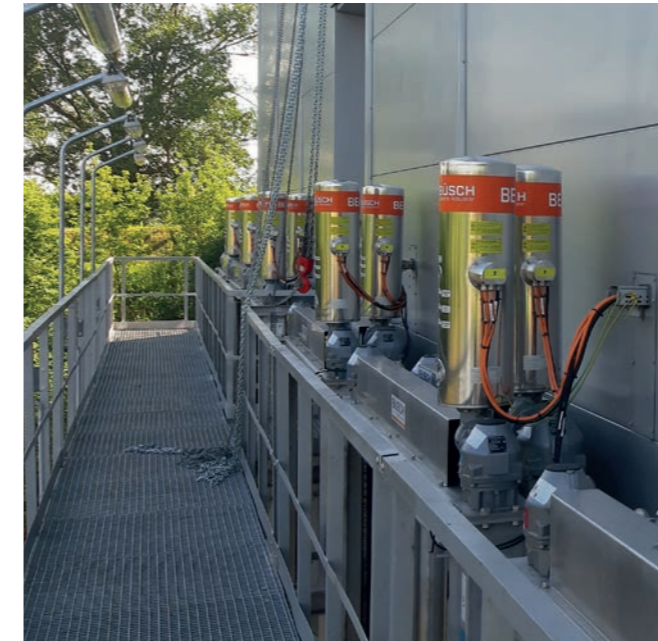
WASSERKRAFTWERK ŻERAŃ – WARSCHAU, POLEN HYDROPOWER PLANT ŻERAŃ – WARSAW, POLAND
