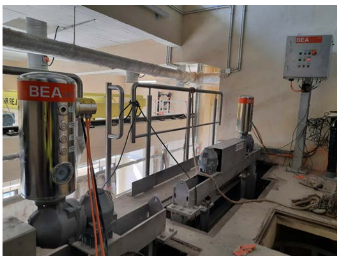
Pompownia ZERO – Warszawa, Polska Pump Station „ZERO” – Warsaw, Poland
