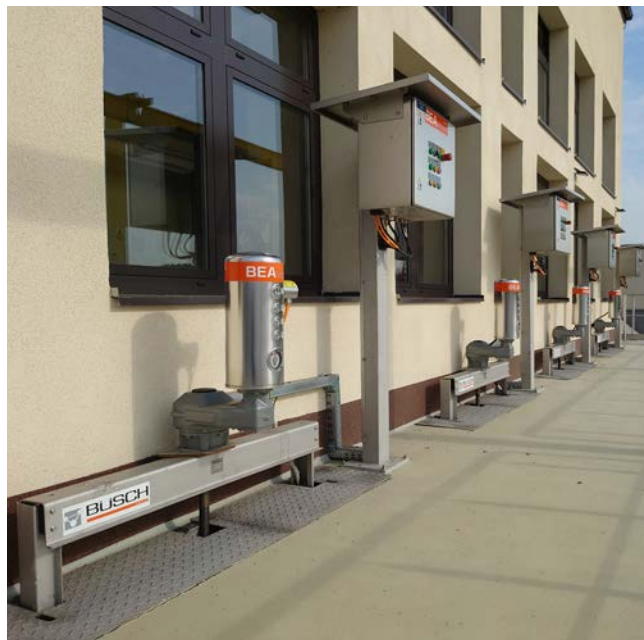
Pompownia ZERO – Warszawa, Polska Pump Station „ZERO” – Warsaw, Poland
